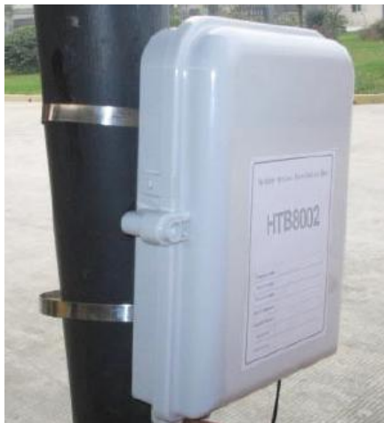
BOX-2-16C Instalado en poste
