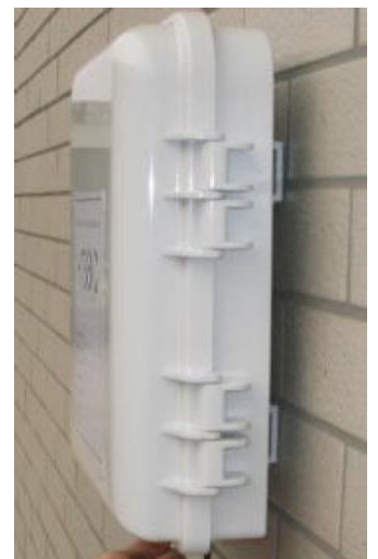
BOX-2-16C Instalado en muro
